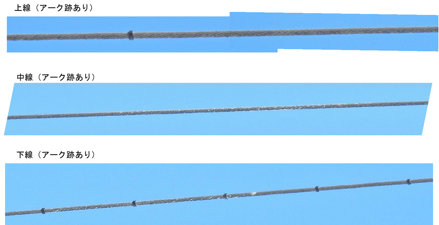
4 電線クレーン接触箇所
