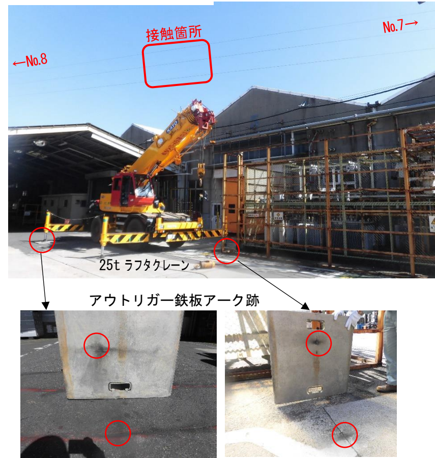
3 クレーン接触箇所
